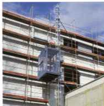
Personen- und Lastenaufzüge
